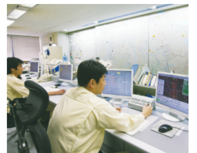
配電自動化システム
