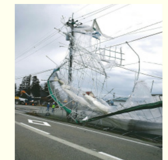
強風による配電線被害
