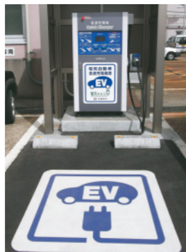
急速充電装置
