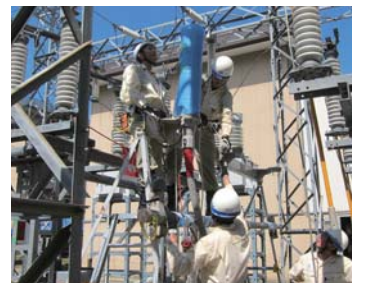
変電部門技能競技会
