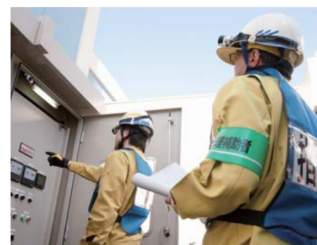
大容量電源車による給電訓練
