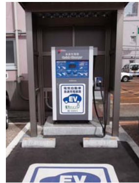
急速充電装置
