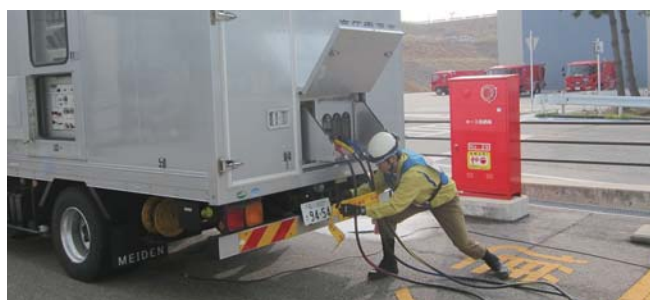
高圧電源車による給電訓練 高圧電源車を使用した緊急時対策所への給電を行う訓練
