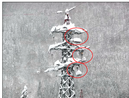
第5図 塔上開閉装置冠雪状況
