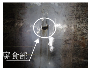
第15図 腐食状況 (腐食部除去中)
