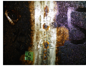
第4図 内面腐食状況
