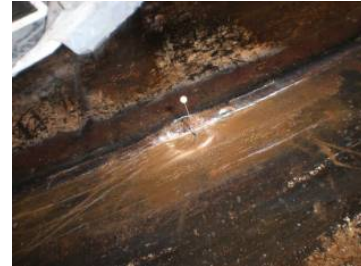
第6図 孔食深さ確認状況
