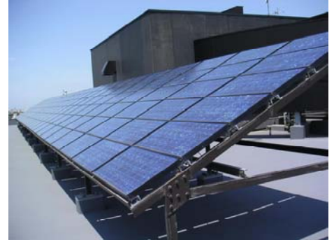
写真 1 太陽光発電（太陽光パネル）
