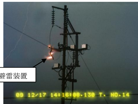
写真1 雷カメラで捉えた避雷装置破損の瞬間
