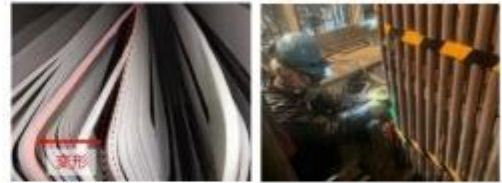
変形したボイラー配管と補修作業の様子
