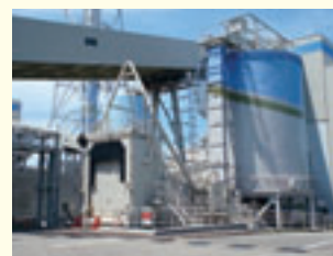
七尾大田火力発電所の 木質バイオマス受入設備
