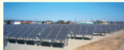
富山太陽光発電所
