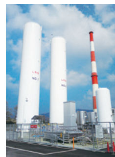
サテライト設備の設置例 写真ご提供：東洋紡株式会社 様
