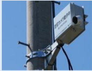
防犯カメラ設置
