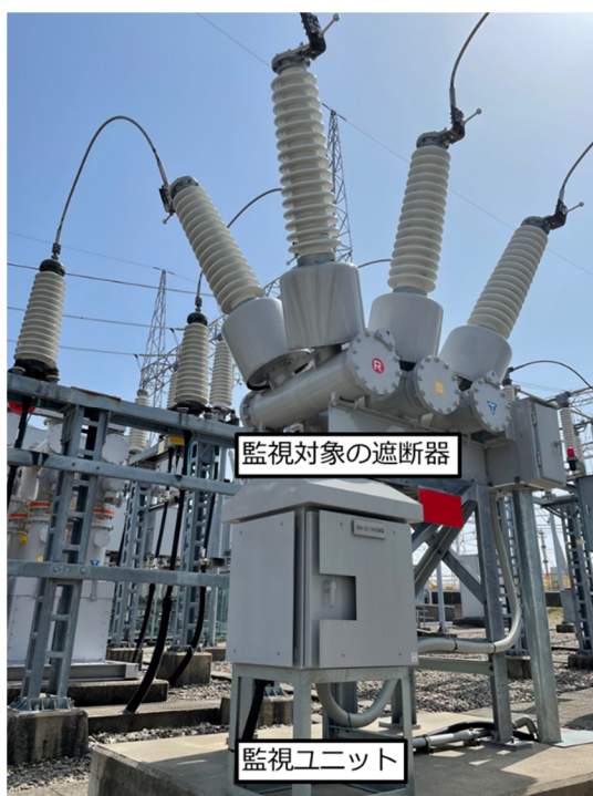
状態監視を行う遮断器（写真）
