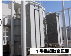
1号機起動変圧器
