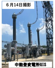
中能登変電所GIS
