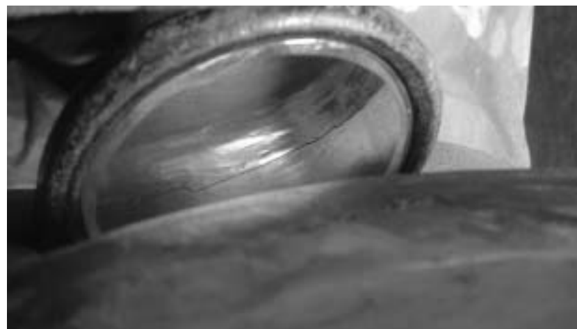
ひび発生箇所写真 (狭隘部のため鏡にて撮影)
