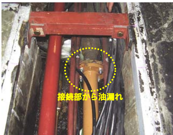
図 2 (a) 油が漏れ出した配管接続部
