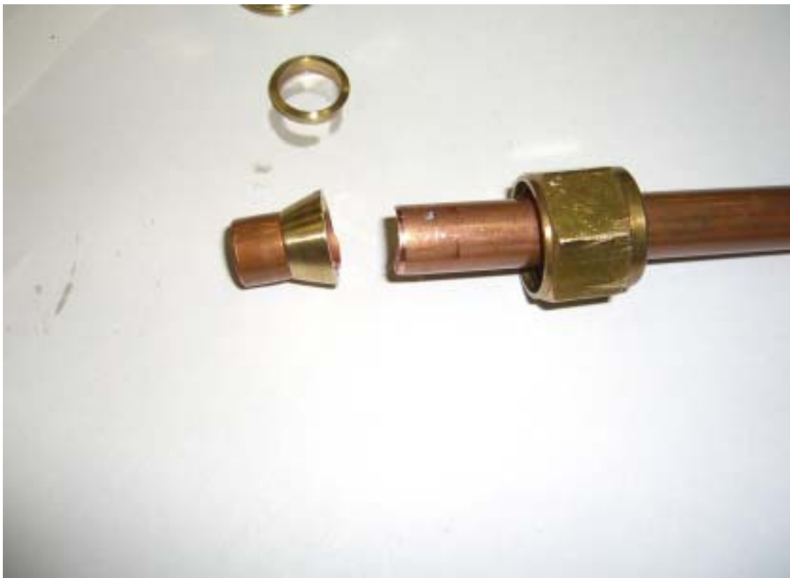
銅管破損状況 銅管サイズ 12 肉厚1.2
