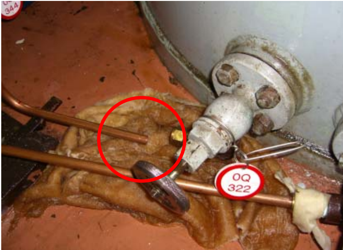
0Q322の切替弁側で銅管破損
