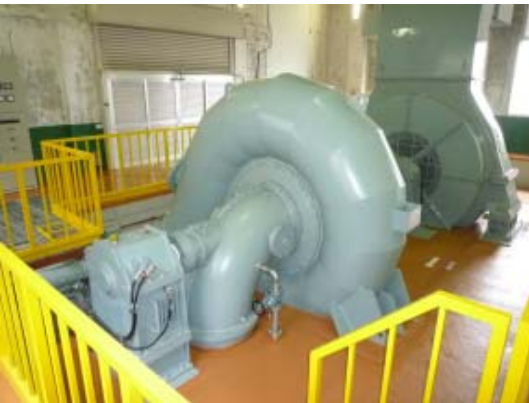
上滝発電所 取替後の3号水車
