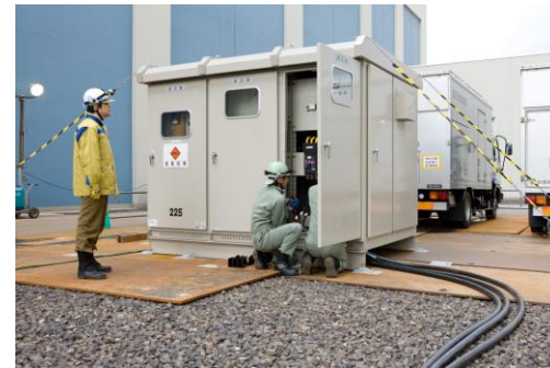
①-3非常用電源の確保 ケーブル、変圧器の配備 (写真は電源車による給電訓練時の様子)
