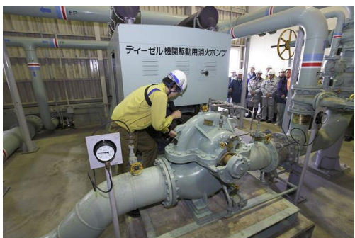
⑦-3緊急時対応訓練の実施 ディーゼル消火ポンプ起動訓練
