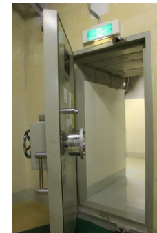
㊾海水熱交換器建屋の浸水対策の強化 扉の水密化等【構造設計中】
