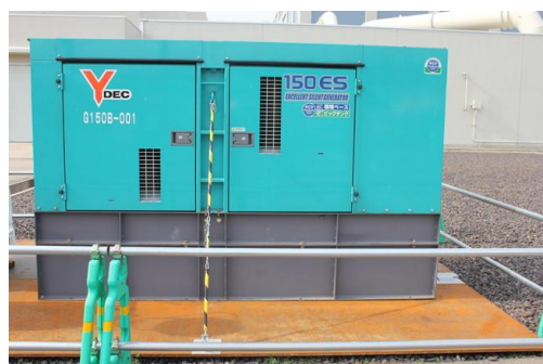
①-2非常用電源の確保 低圧発電機の配備
