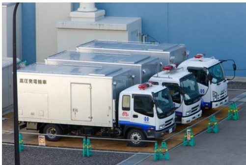
①-1非常用電源の確保 電源車の配備
