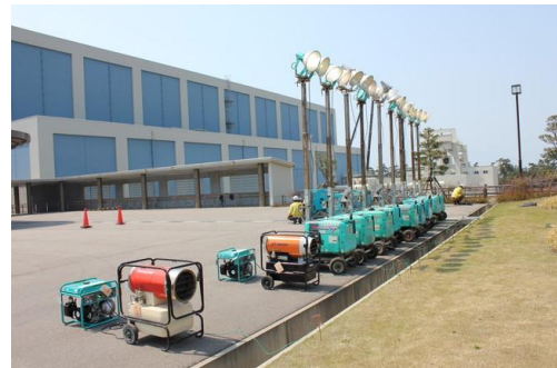
㊹-1原子炉補機冷却系ポンプの機能回復手段の整備 洗浄・乾燥用の資機材の配備【実施済】
