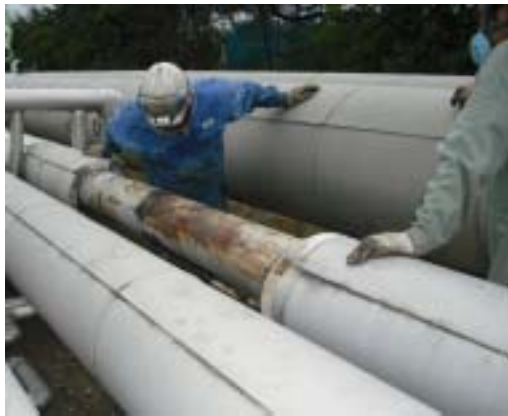
燃料配管外観
