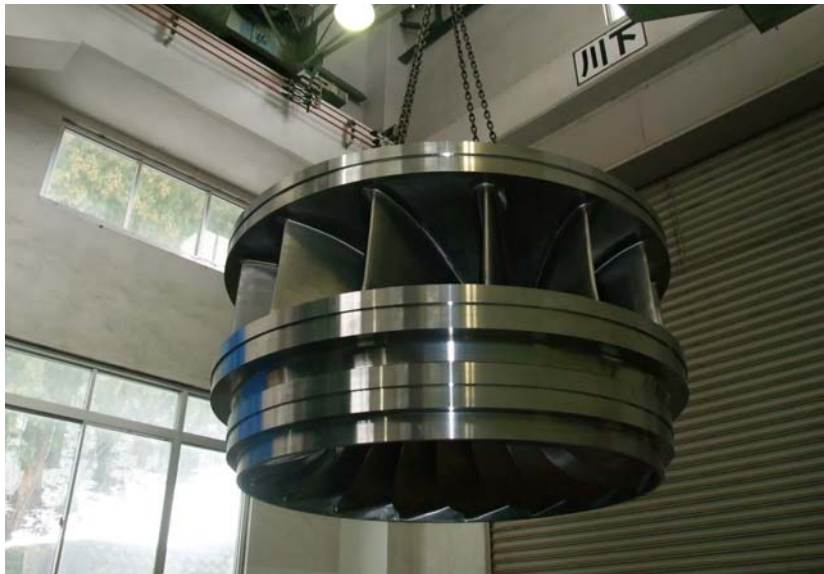
五条方発電所 1号水車ランナ
