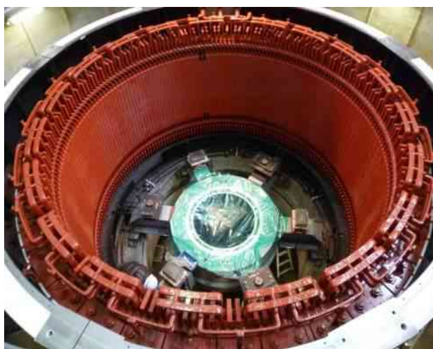
発電機固定子
