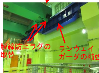
天井クレーン （写真は反対側の部分）
