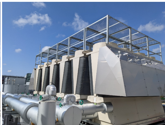
空調設備（ヒートポンプチラー）
