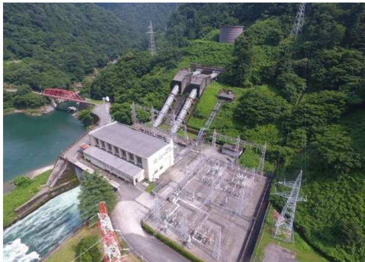
神通川第一発電所 全景
