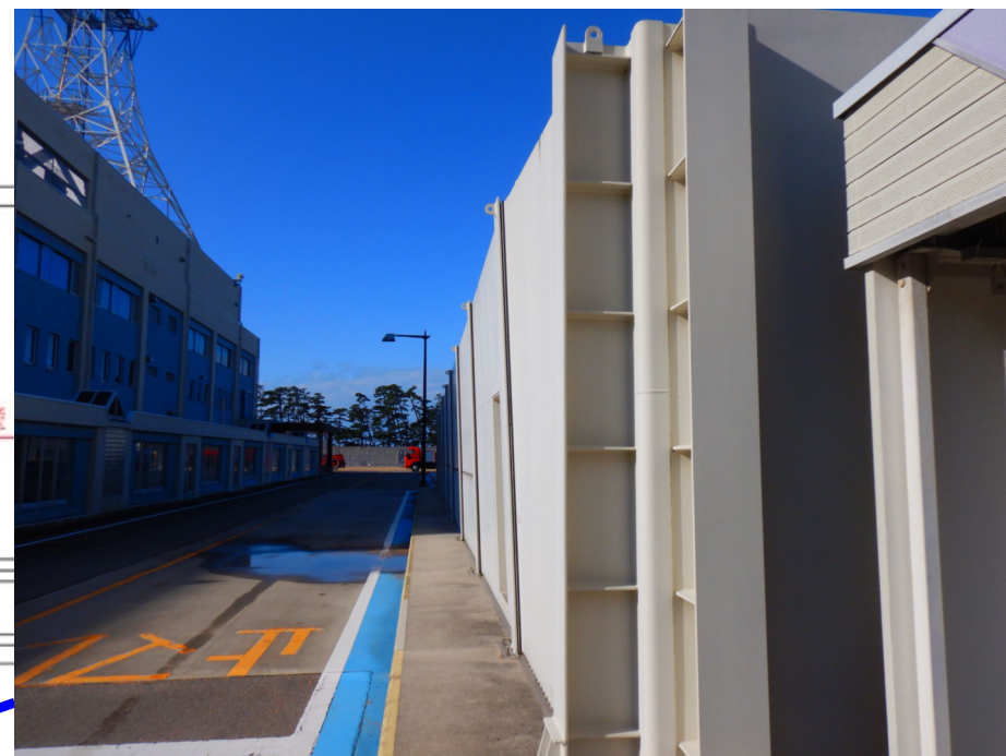
防潮壁の南側壁が事務本館側に全体的に傾きあり。
