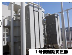
1号機起動変圧器
