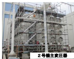
2号機主変圧器
