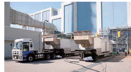
大容量電源車 [4,000kVA]
